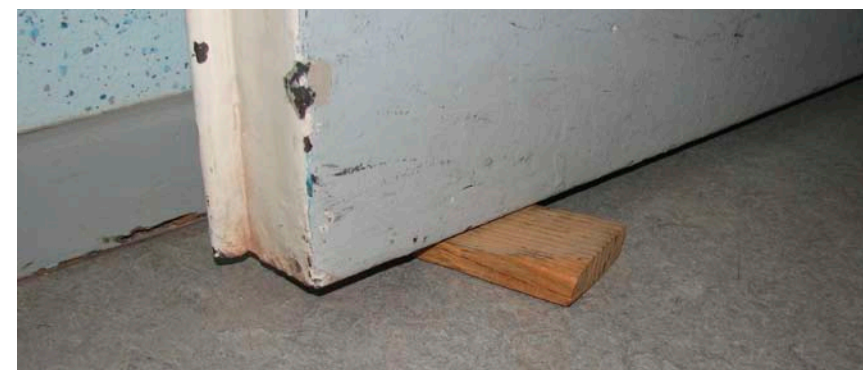
Eine offene Brandschutztür nützt bei einem Brand nichts. Yangından korunma kapısının açık olması durumunda bir yangın esnasında faydası olmaz. Otwarte drzwi przeciwpożarowe nic nie dają przy pożarze. Открытая противопожарная дверь не спасает при пожаре.
