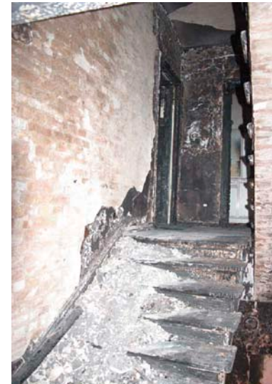
Wohnungstür nach einem Treppenhausbrand von außen... Ana giriş kapısı bir merdiven boşluğu yangınından sonra dışarıdan... Drzwi mieszkania z zewnątrz po pożarze na klatce schodowej... Входная дверь с внешней стороны после пожара ....
